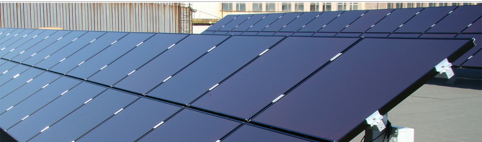
Слънчева централа на разположена на покрив
