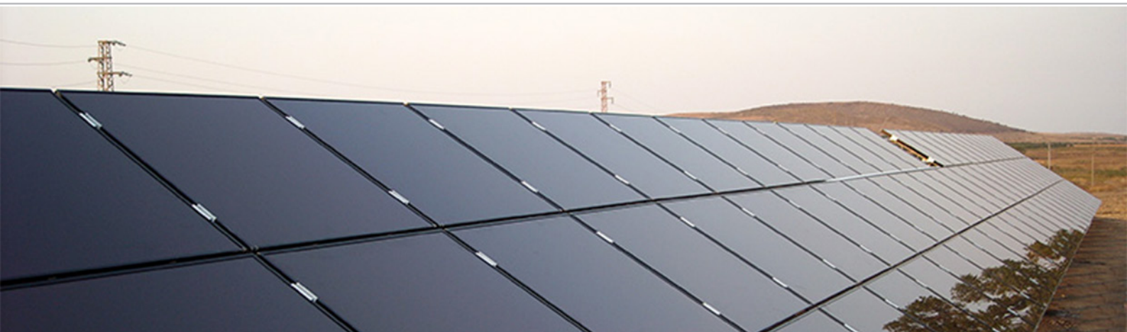
Слънчева централа на разположена на покрив
