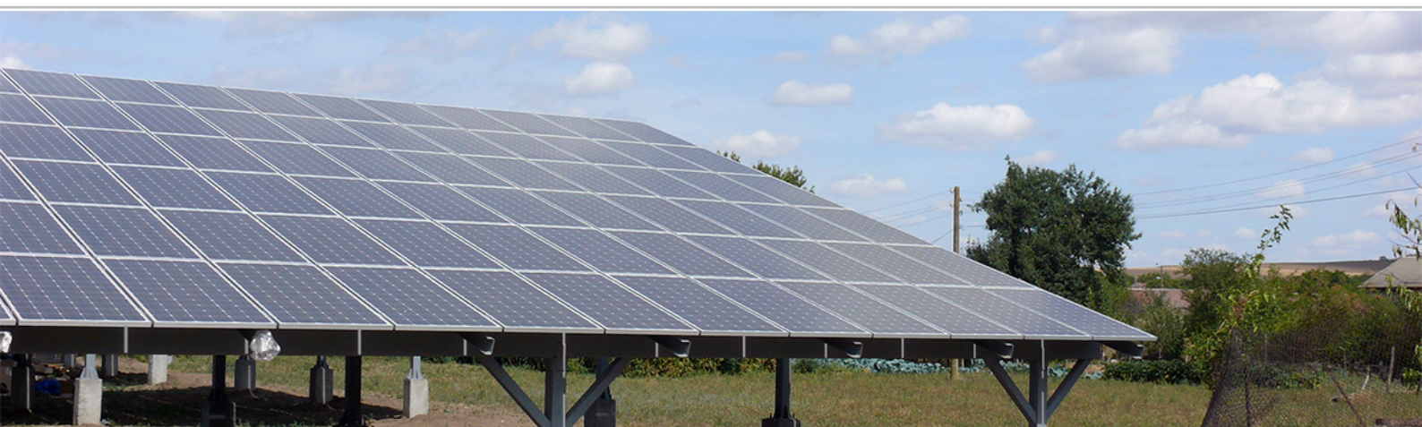
Слънчева централа разположена на единична конструкция
